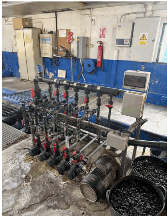
Exterior.Cabezal de Riego
